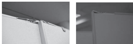
図2 破損している掲示板
